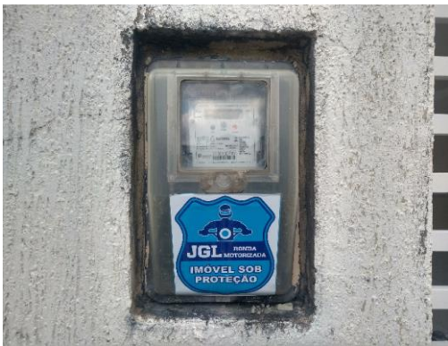
MEDIDOR DE ENERGIA
